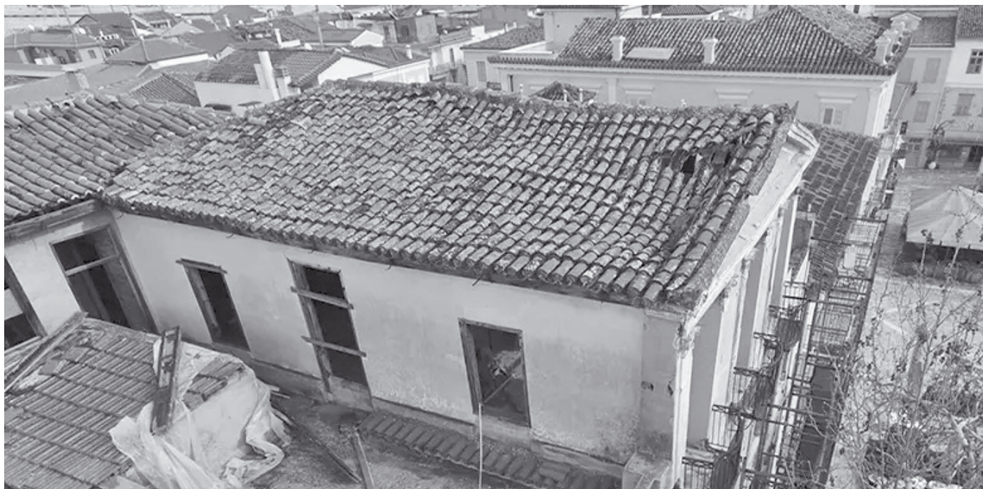
Το κτήριο Βίγγα εγκαταλελειμμένο και ερειπωμένο
